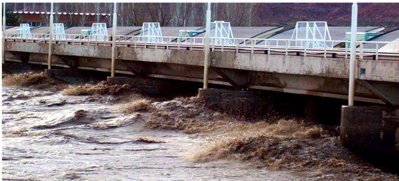
CRECIDA DE 2006 - ESTRUCTURA DE DEVÍO DEL RÍO NEUQUEN A LOS BARREALES, EN PORTEZUELO GRANDE
